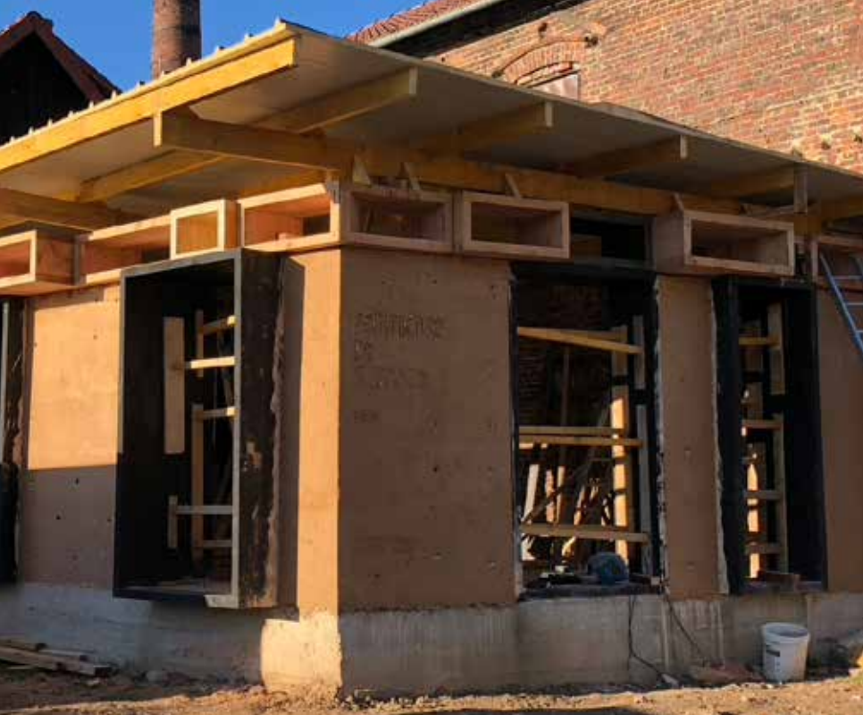
Bâtiment en cours de finition : larges débords de toiture en attente de revêtement de finition, pour protéger les murs de l'eau pluviale. Les murs très épais apportent une grande inertie au bâtiment et dispensent d'isolation intérieure. Les cadres des ouvertures recevront bientôt des vitrages isolants.
