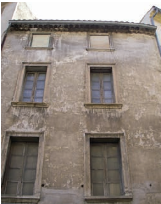
Sous la grisaille du temps, cette façade est enduite au plâtre (Haute Provence).
