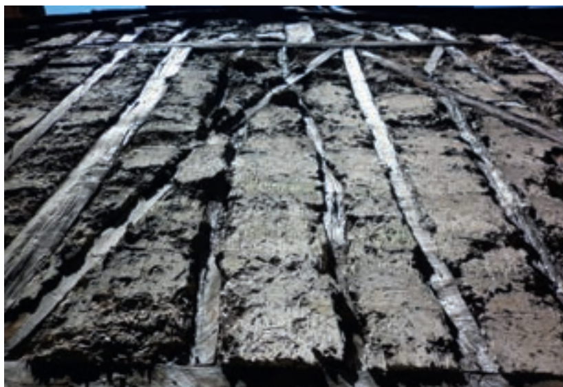
Figures de dissolution verticales sur cet enduit plâtre recouvrant un mortier paille-plâtre ancien, à Tarascon (Ariège)
