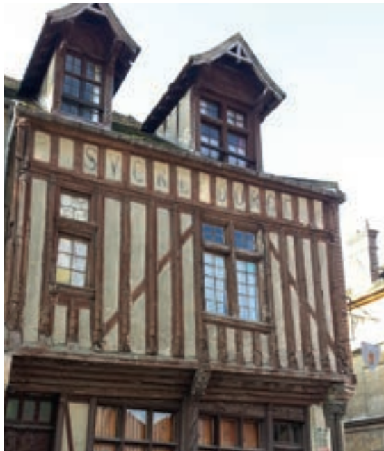
Maison urbaine en pans de bois apparents à Moret-sur-Loing (Seine-et-Marne). Hourdis enduits au plâtre.
