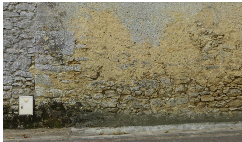
Pied de mur avec enduit qui se délite.
